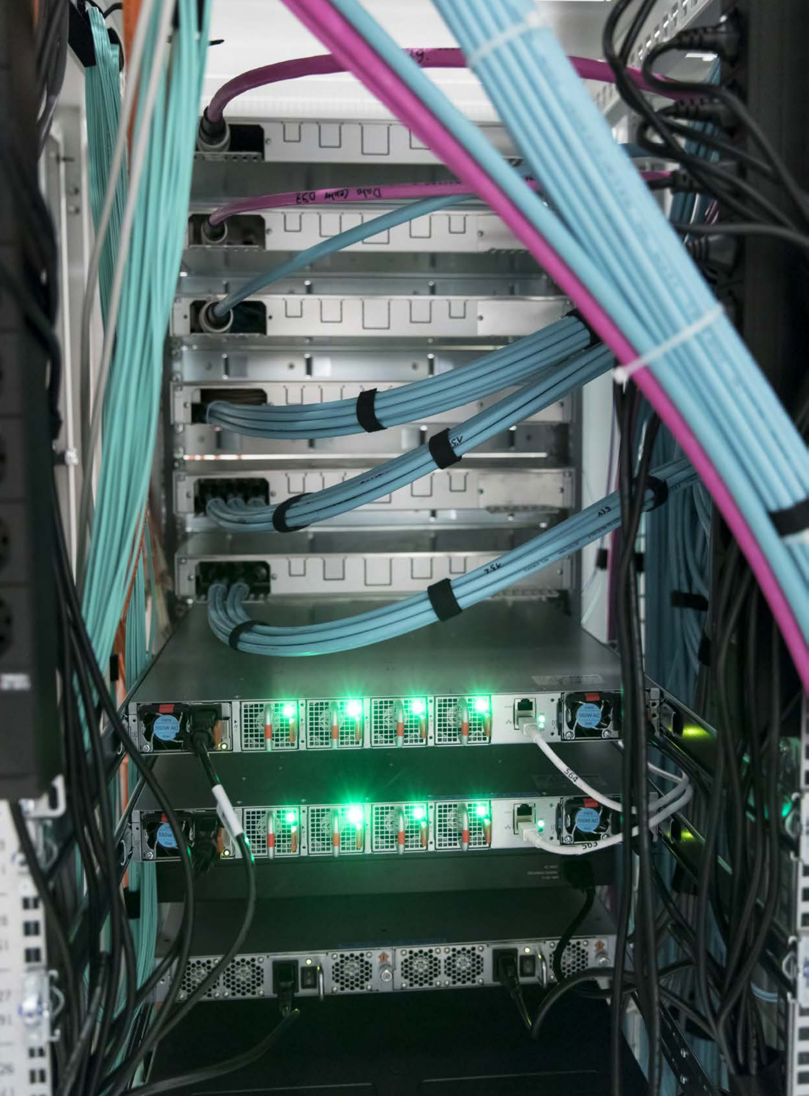
Un réseau informatique complexe et sécurisé permet le bon fonctionnement des installations.
